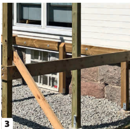
3 Remmen, der sidder på husets facade, er fæstnet med franske skruer. Hvis ikke facaden er skruefast, så er det nødvendigt at understøtte den med lodposter som her.
