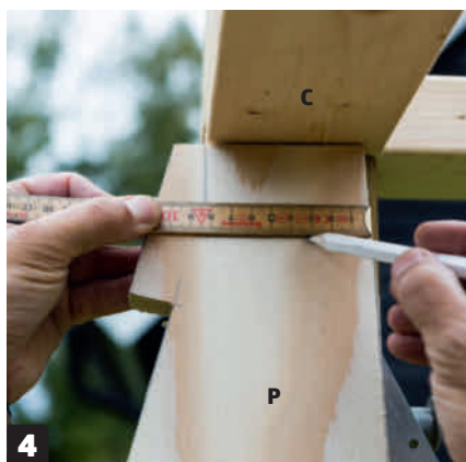
4 Vangerarna (P) anpassas överst. När alla hack är klara tar vi bort en bit upptill så att vangeren kan glida in mellan syll och hammarband. Det ska finnas plats för att lyfta upp vangeren över upphängningen.
