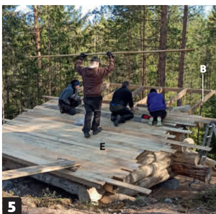
5 Taket lages av 22 x 98 mm (E) bord oppå taksperrer av 48 x 148 mm (B). Takbordene legges kant mot kant, spikres fra oversiden og renskjæres i kantene til slutt.
