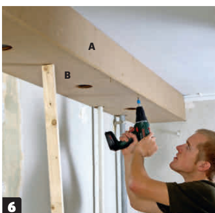
6 Skruva på undersidorna (B). Lyft dem på plats och stötta på mitten med en regel som spänns mot golvet. Skruva därefter fast undersidorna med 3,5 x 40 mm skruv.
