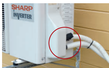
Rørtilkoblingen mellom pumpa og huset kan komme til å sitte i veien for ei avskjermingskasse.
