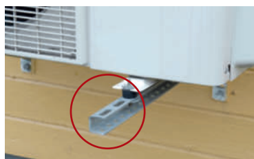
Denne pumpa er satt fast til braketter som stikker langt ut. De kan også brukes til montering av kassa.
