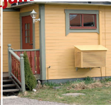
Puinen suojus, joka on maalattu talon väriksi, tekee pumpusta vähemmän silmiinpistävän.
