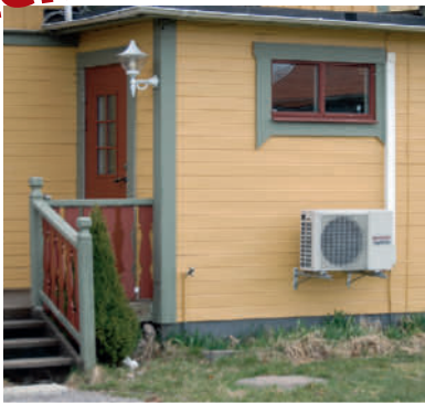
Ilmalämpöpumppu on sijoitettu sisäänkäynnin viereiselle seinustalle. Se ei juuri korista taloa.
