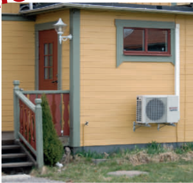
Luftvärmepumpen sitter på väggen precis intill den lilla farstukvisten. Och snygg är den ju inte ...
