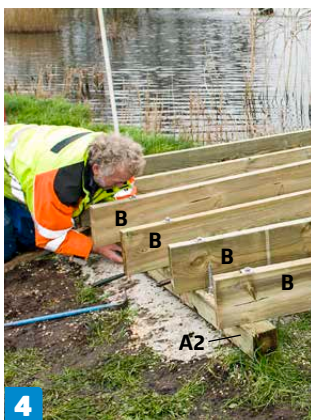
4 På undersiden af bjælken (A2) låser du strøerne (B) fast med skiver og møtrikker. Strøerne i midten rager længst ud, fordi vi vil runde dækkets kant af.
