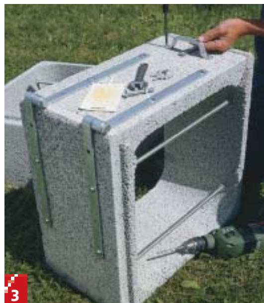
3 Lågen i elementet B skæres med en fukssvans. Hængslerne limes med tokomponent lim (hængslets limside raspes først) og skrues fast med bolte – husk spændeskiver på indersiden.
