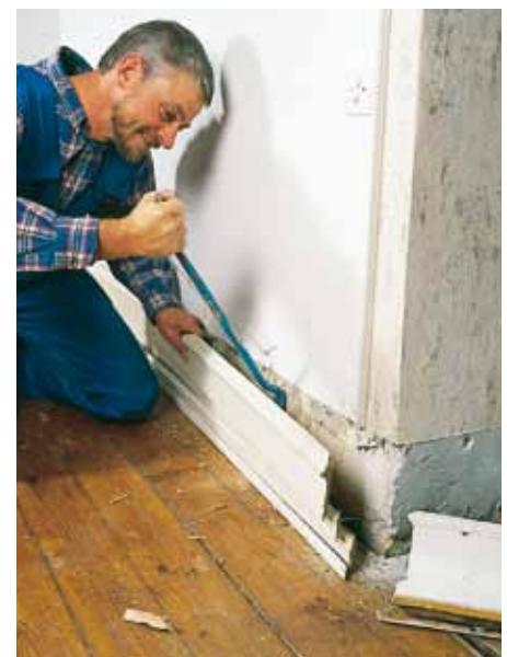
Fjern først fodpanelerne med et koben. Kan de løsnes uden at tage skade, kan de monteres igen oven på det nye parketgulv.
