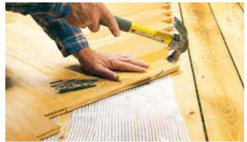
Det kræver både tålmodighed og akkuratse at lægge det massive gulv i mønster. Hver stav skal placeres præcist i limen og sømmes fast.
